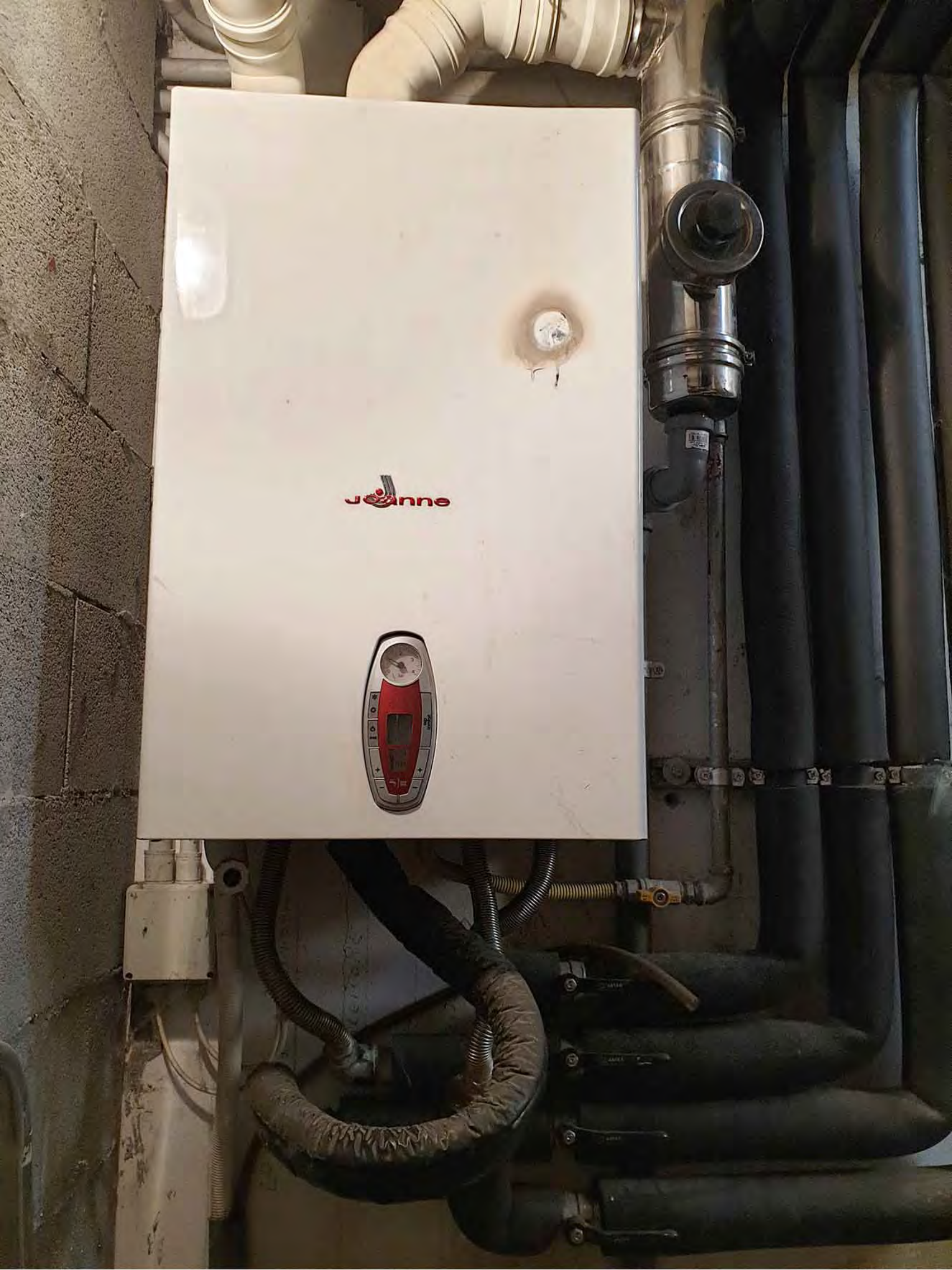
CALDAIA IN USO
