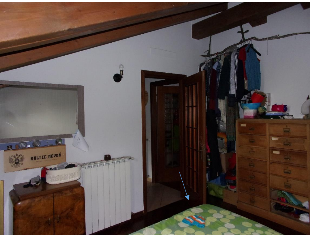
Foto 9: camera matrimoniale, indicata con freccia zona parquet rovinato
