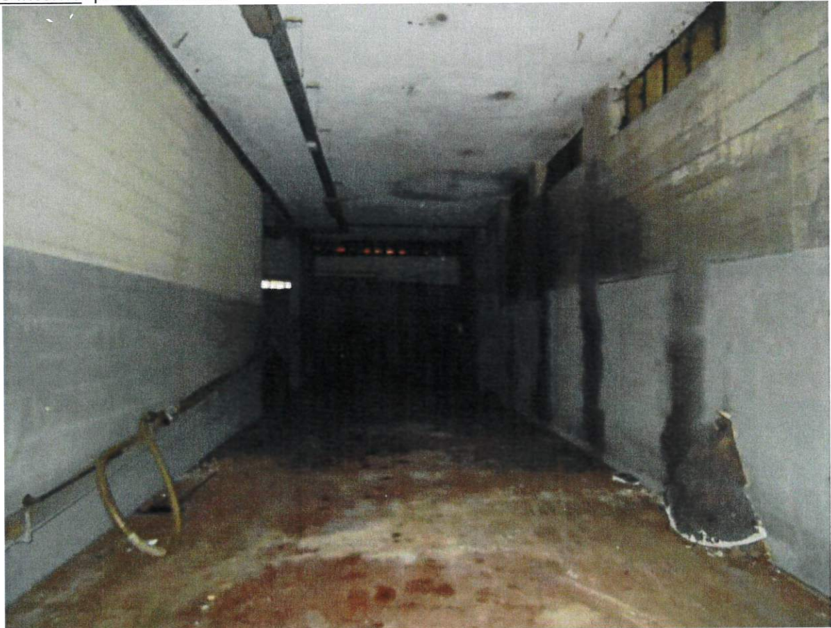
Foto 6: deposito vini sfusi
