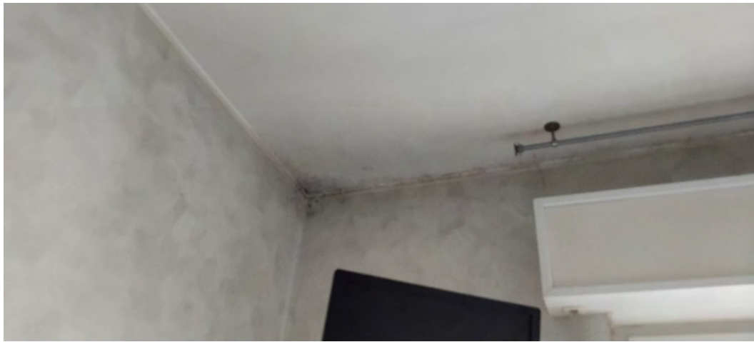
Infiltrazioni/ponte termico soffitto camera
