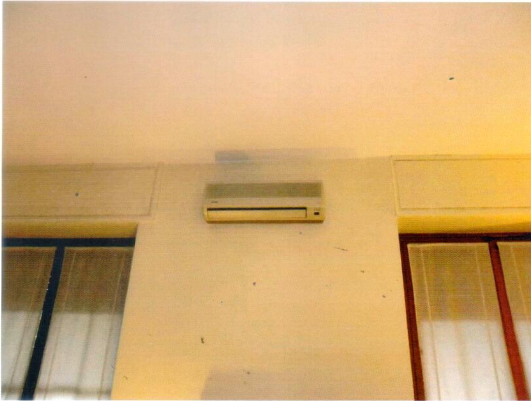
Particolare aria condizionata
