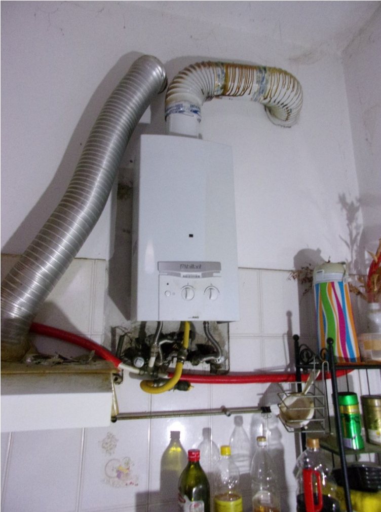
Foto 9: caldaia piano terra zona angolo cottura
