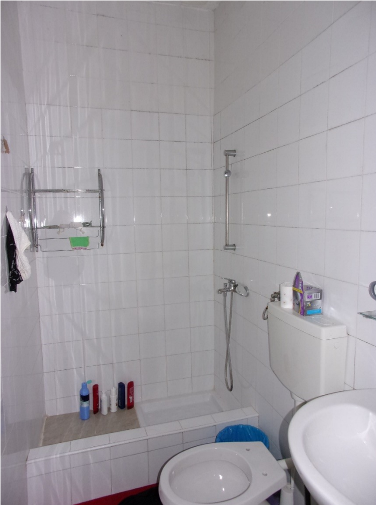
Foto 18: bagno abusivo piano primo
