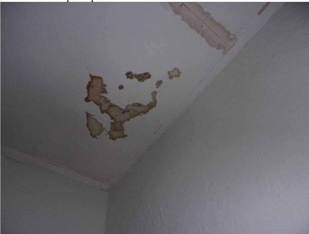
Foto 15: umidità per infiltrazioni dal tetto
