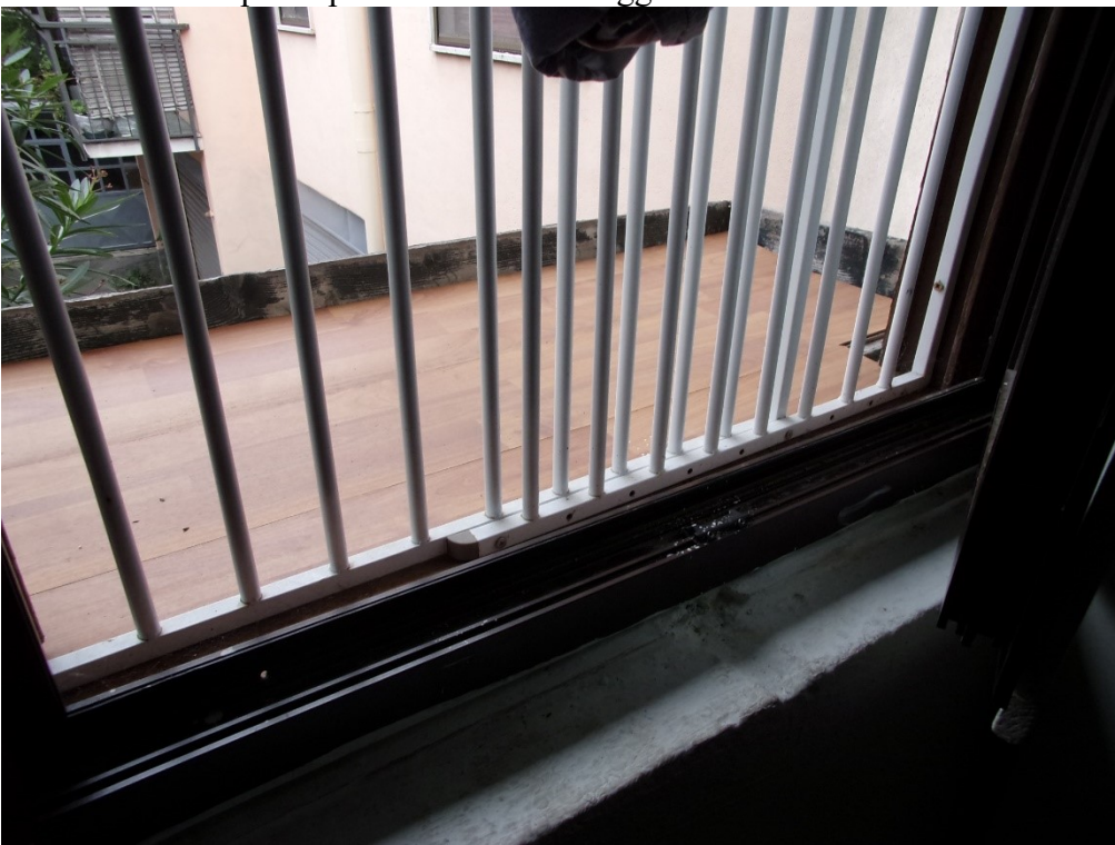
Foto 17: oggetto abusivo da rimuovere dalla finestra della camera del piano primo
