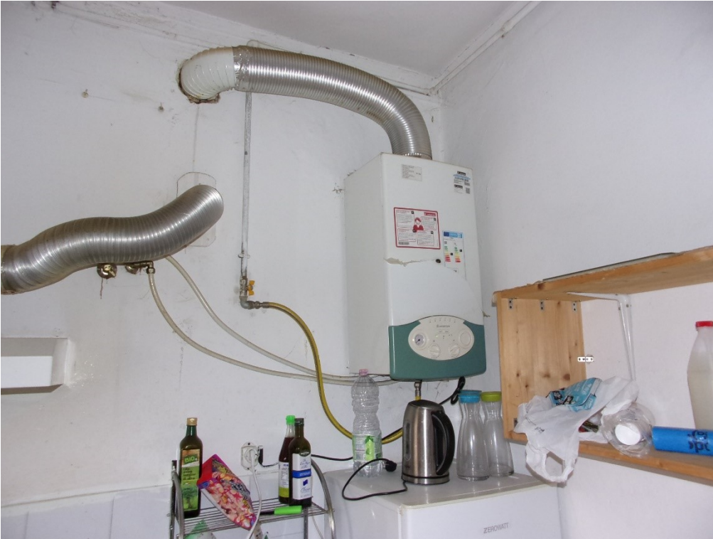
Foto 20: caldaia zona angolo cottura piano primo
