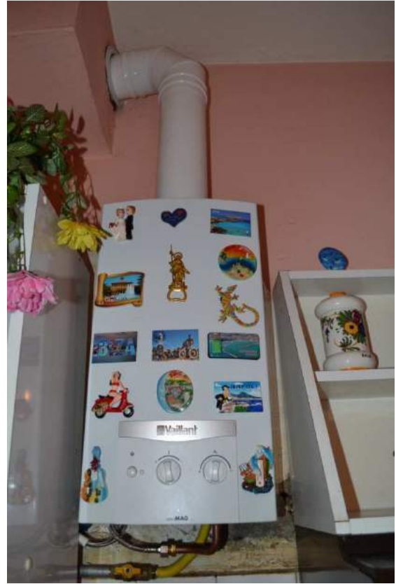
FOTO N. 10 – Boiler acqua calda
