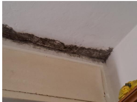
30. Soffitto del locale cucina/soggiorno
