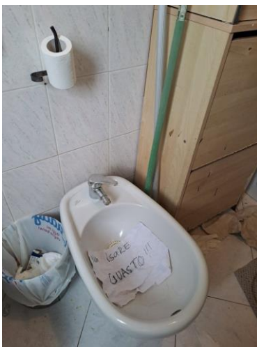
19. Sanitario guasto nel bagno
