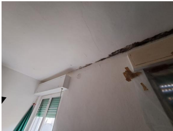
29. Soffitto del locale cucina/soggiorno
