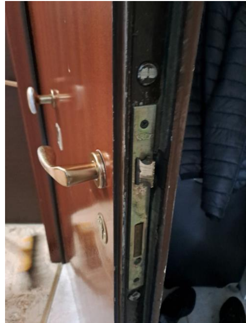
8. Portoncino di ingresso all'appartamento pignorato
