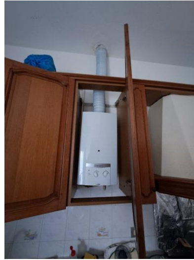
28. Caldaia per acqua calda in cucina
