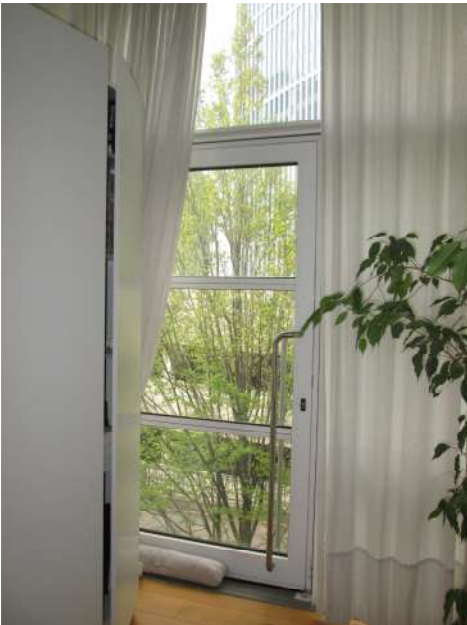
7) Realizzazione di porta finestra in difformità
