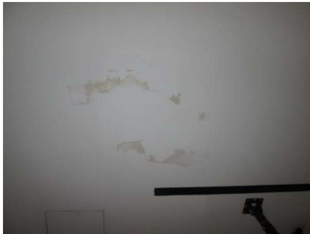
8) Infiltrazione solaio (non conosciuta la causa) locale usufruito a salotto
