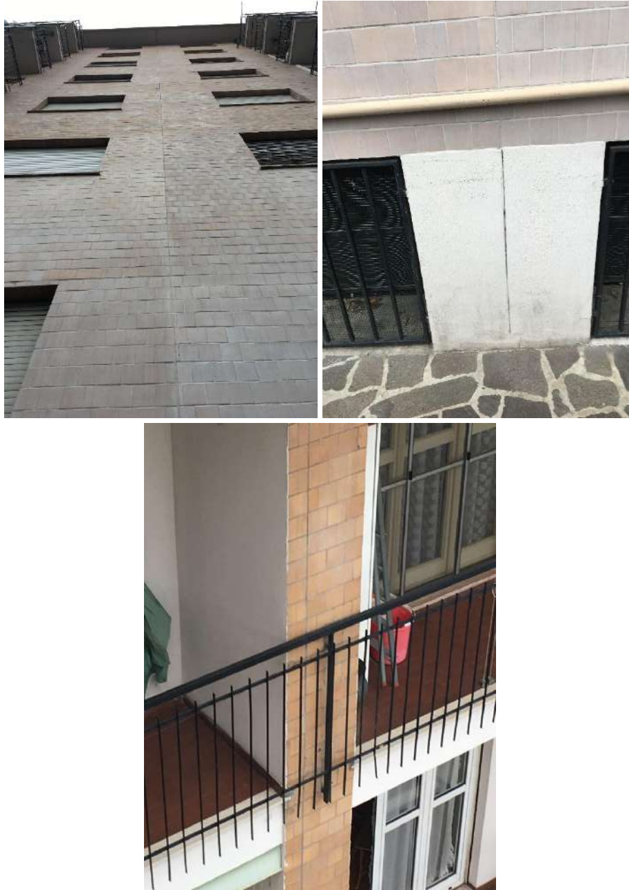
Figura 27 – particolare del giunto strutturale sulle facciate zona 4 (in alto) e zona 3(in basso)
