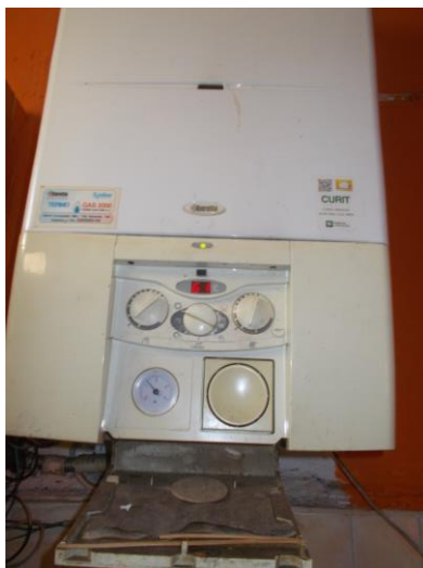
29. Sub 503: caldaia in cucina
