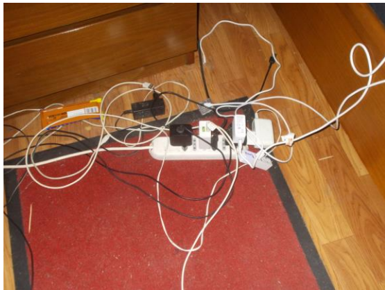
37. Sub 502: collegamenti elettrici
