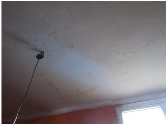
27. Sub 503: soffitto del soggiorno
