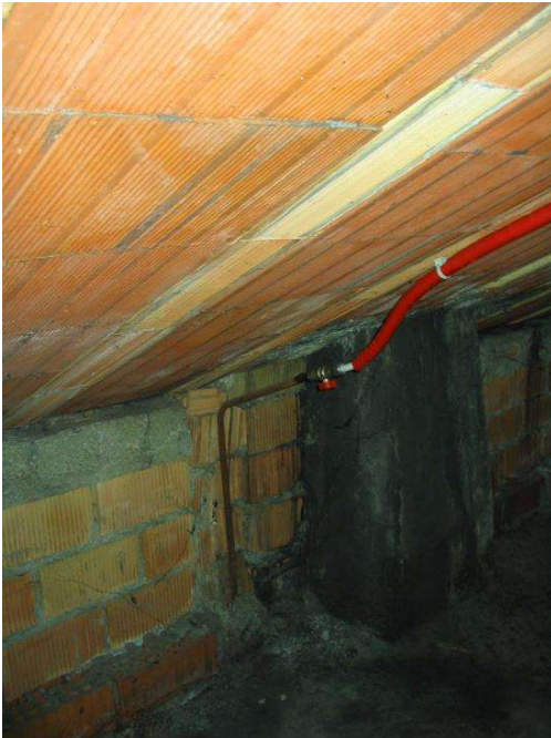
Foto 11: Passaggio impianti comuni
