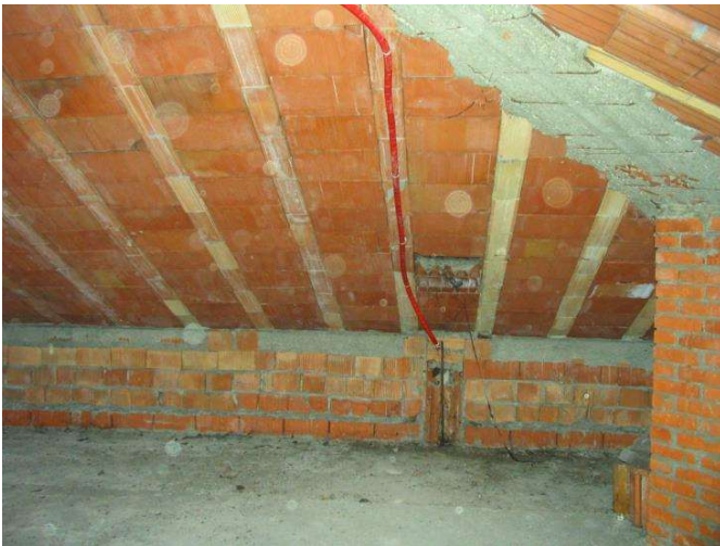
Foto 8: Solaio/ Deposito parete verso corte
