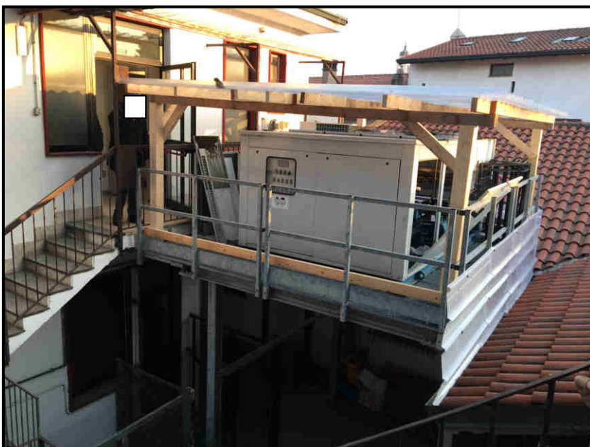
Macchina frigorifera posta nel cortile comune
